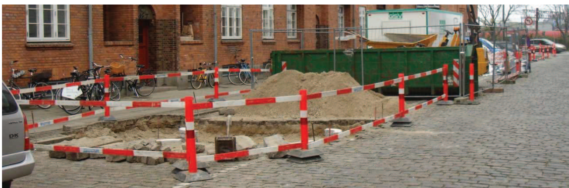
Figur 5.6. Eksempel på stationært vejarbejde på lokalvej i byområde med beskyttelsesniveau 2. Kant- og baggrundsafmærkning.
