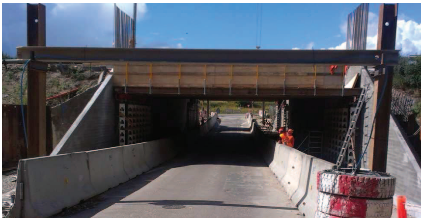
Figur 6.54. Eksempel på stopportal (med foranstående højdevarslingsportal uden for billedet)
