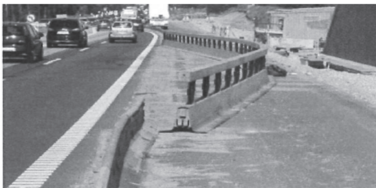
Figur 6.46. Eksempel på påkørt trafikværn med manglende forankring, overlap eller overgangsstykker
